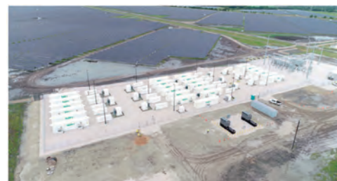
アメリカ・テキサス州におけるLily Energy Storage Project
