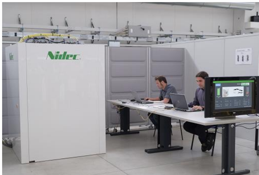
NASIのウルトラファストチャージャー（超急速充電システム）
