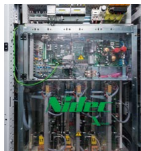
BESS不可或缺的功率转换系统
