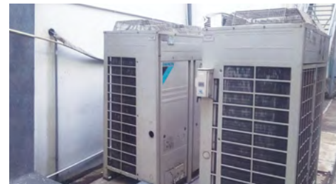
安装有节能运转控制装置的日本电产东侧越南的空调设备
