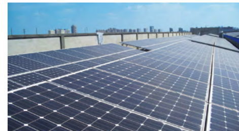
在日本电产(浙江)有限公司安装的光伏发电板
