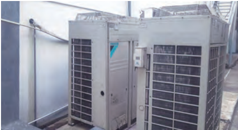
安装有节能运转控制装置的日本电产东侧越南的空调设备
