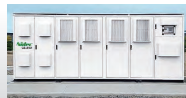
电池储能系统 (BESS)
