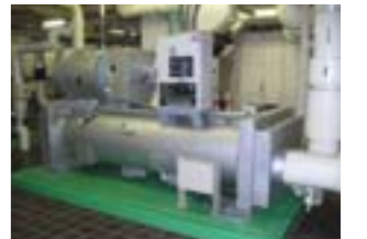
本社 高効率ターボ冷凍機の採用
