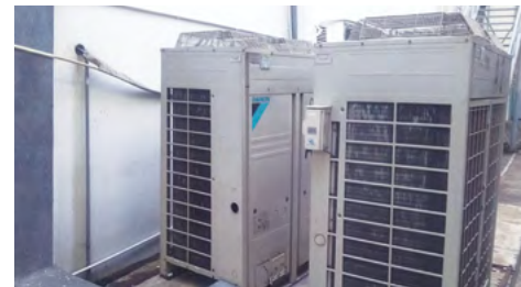
省エネ用の運転制御装置を取り付けている日本電産トソク・ベトナムの空調設備
