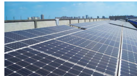
日本電産(浙江)有限公司に設置されている太陽光発電パネル
