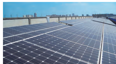
日本電産(浙江)有限公司に設置されている太陽光発電パネル
