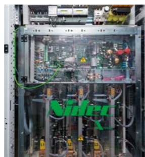
BESSに不可欠な電力変換システム
