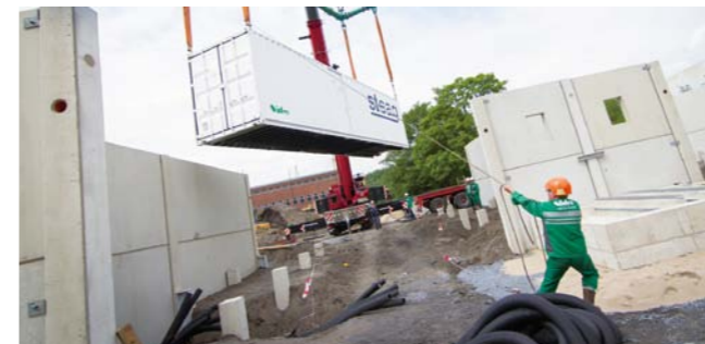
德国的电池储能系统
